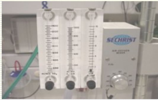
Foto 9: Sistema de administración de gases
