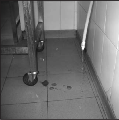
Riesgo de accidente por caída al mismo nivel (suelo resbaladizo por agua en cocina)
