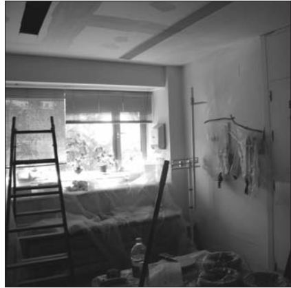
Riesgo de accidente de trabajo por caída de techo en centro de salud
